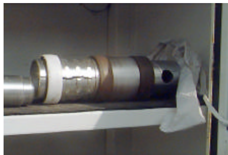
Foto 1: Se observa la fisura en donde se dañó la barra de mando (casquillo de la parte superior).
