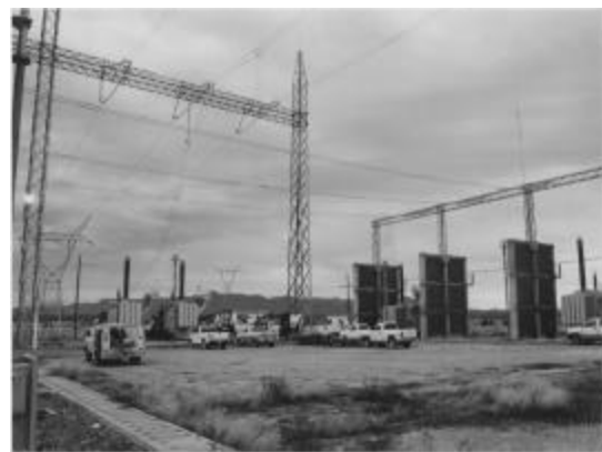
Foto6 : Vista general del arreglo final.
