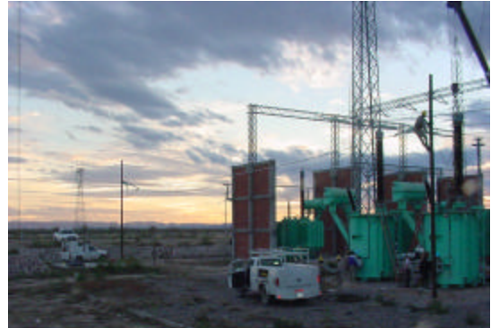
Foto5: preparación del bus neutro para los dos reactores de 25 MVAR
