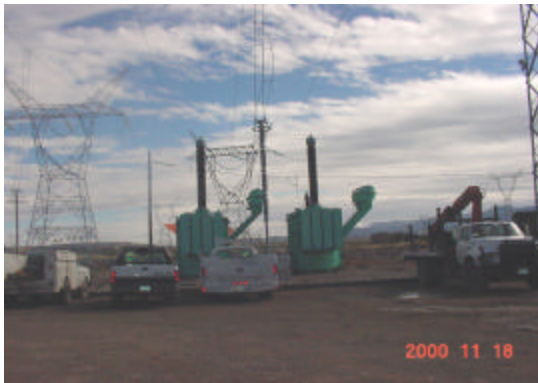
Foto 4: Reactores de 25 MVAR, 400 kv marca ABB, para ser instalados en paralelo y sustituir uno de 50 MVAR
